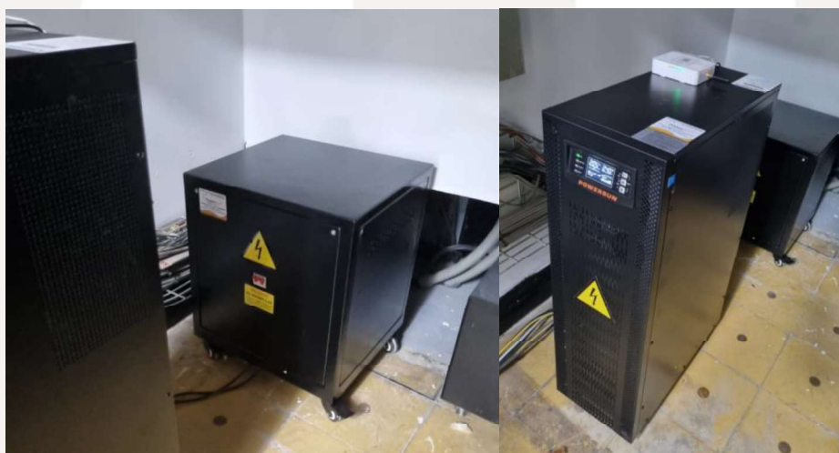
UPS y banco de baterías adición instalados en la sede Bogotá
